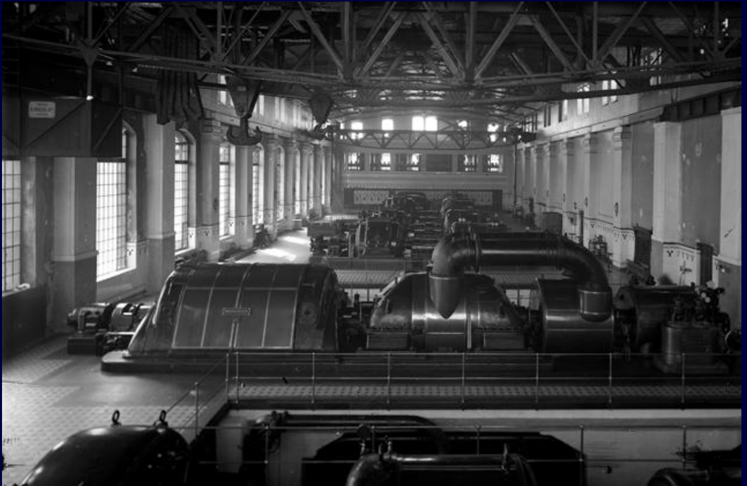
Elektrownia w Łodzi
