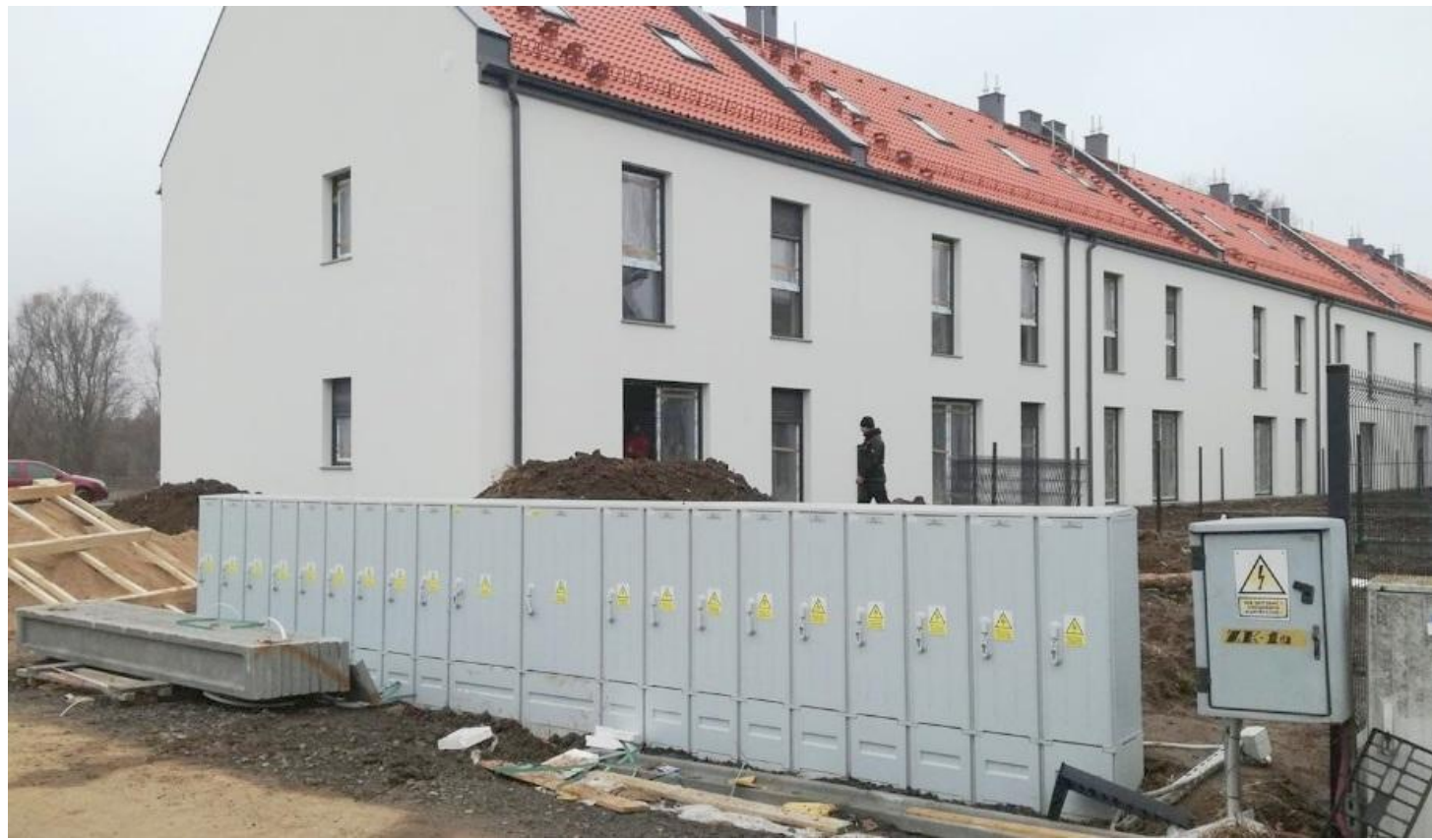
"Ściana płaczu" na nowym osiedlu.
