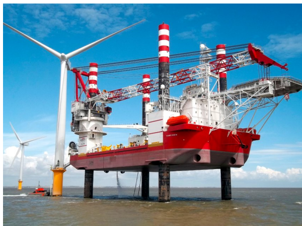
Rys. 3. Montaż elektrowni wiatrowej na morzu przy użyciu wyspecjalizowanego statku. Jednostki tego rodzaju mogłyby być budowane w polskich stoczniach dla krajowego programu MEW [fot. Wind Europe]
