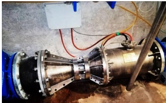
Fot.2. Widok turbiny TKR6 – 150
