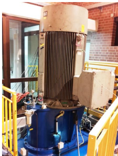
Rys. 2. Generator hydrozespołu o osi pionowej
