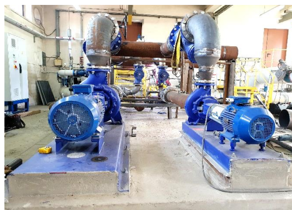
Rys.2 Hydrozespoły PAT w obiekcie Kombatantów 18
