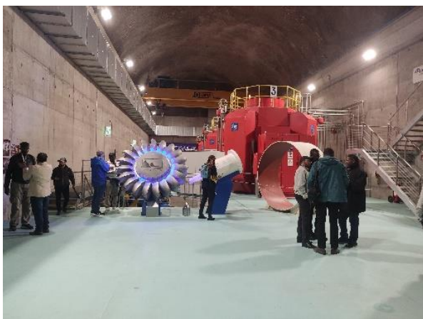
Fot. 3 Elektrownia wodna St. Anton – podziemna hala maszyn
