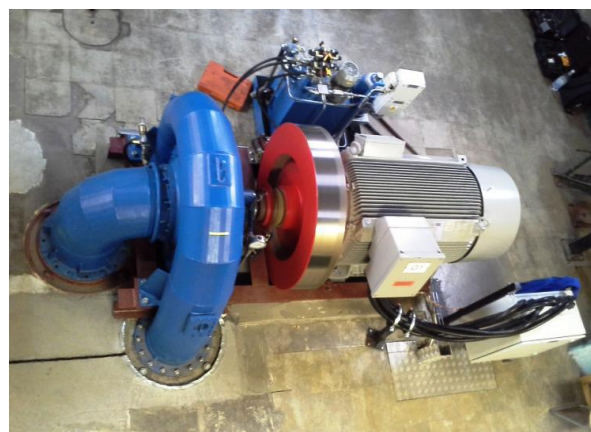
Rys. 1. Hydrozespoł z turbiną Francis o osi poziomej
