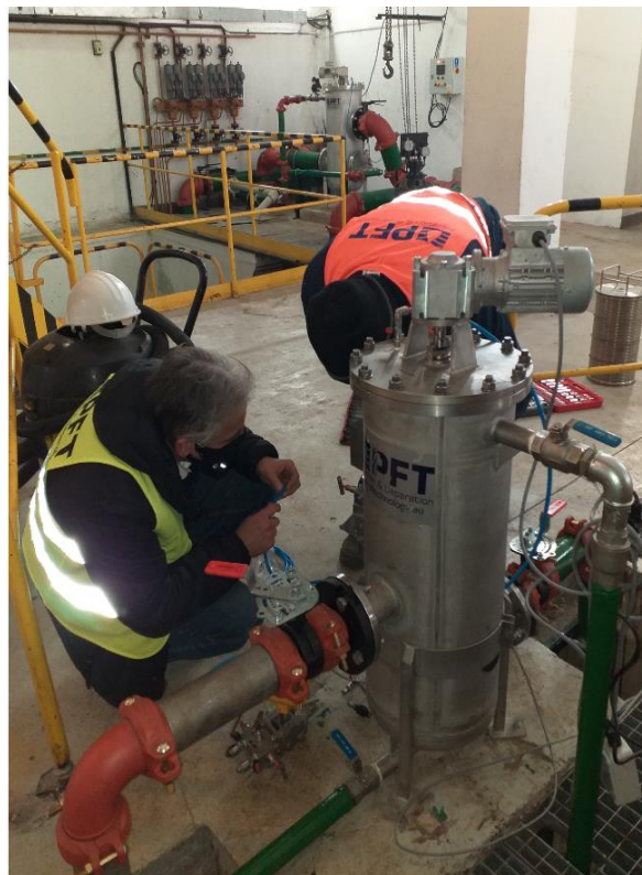
Zdj. 3 Filtr samoczyszczący DN65 o poziomie filtracji 25 \mu\text{m}
