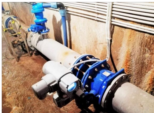
Fot. 4.. Przepustnica regulacyjna w sztolni prawej na rurociągu DN 300
