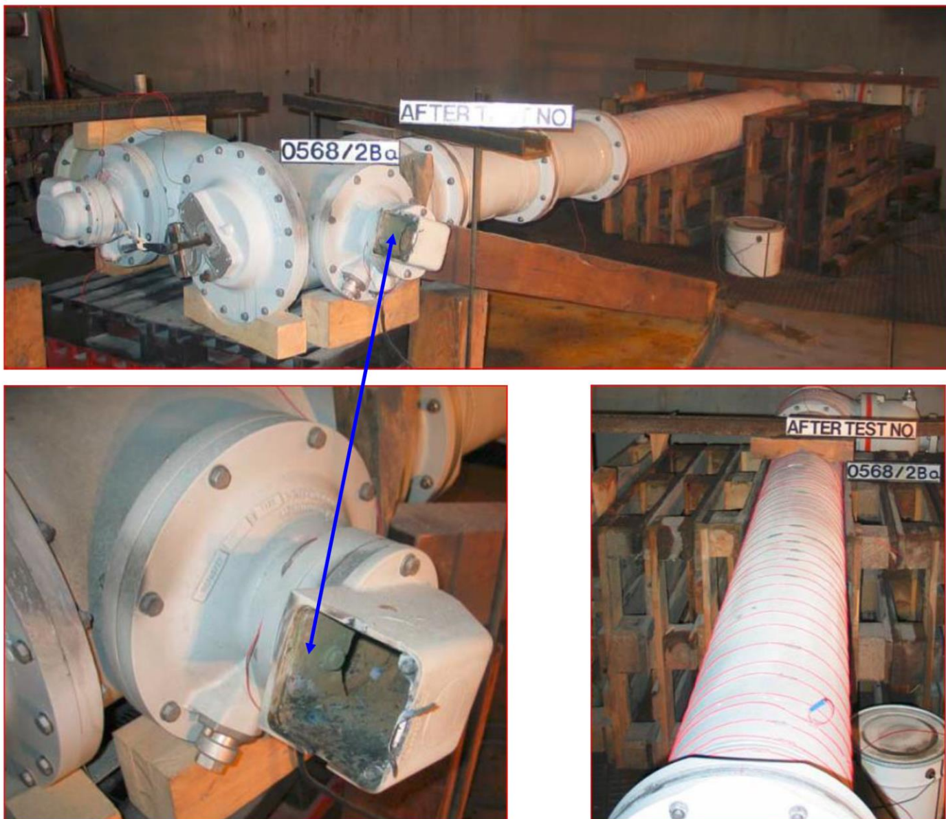
RYS. 4. Stan grupy przedziałów rozdzielnicy GIS typu ELK-14/300 (patrz RYS. 2) na napięcia 220 kV lub 245 kV po zakończeniu próby zwarciowej, z generacją ciśnienia gazu SF 6 przez łuk wewnętrzny (patrz RYS.3), źródło :[6].
