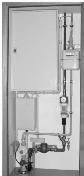
Rys. 6. Wnęka przyłączowa według DIN 18012 [17]. W osobnych zamkniętych szrankach: złącze elektroenergetyczne (większa górna szranka) i złącze telekomunikacyjne (mniejsza dolna szranka).
