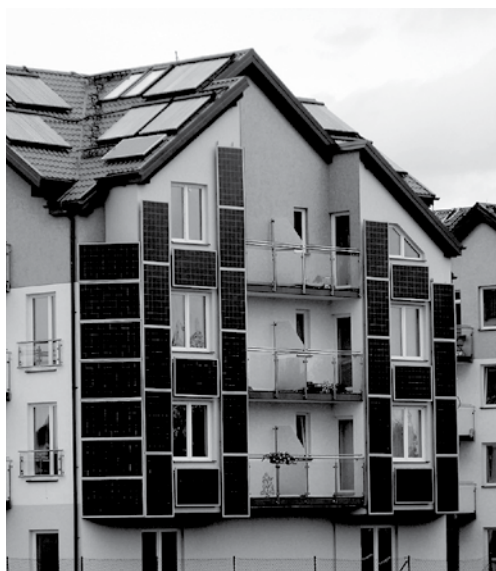
Rys. 1. Przykład instalacji fotowoltaicznej zamontowanej na dachu i ścianie budynku mieszkalnego
