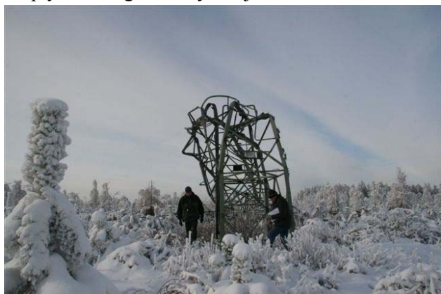
Fot. 11. Uszkodzony słup linii wysokiego napięcia.
