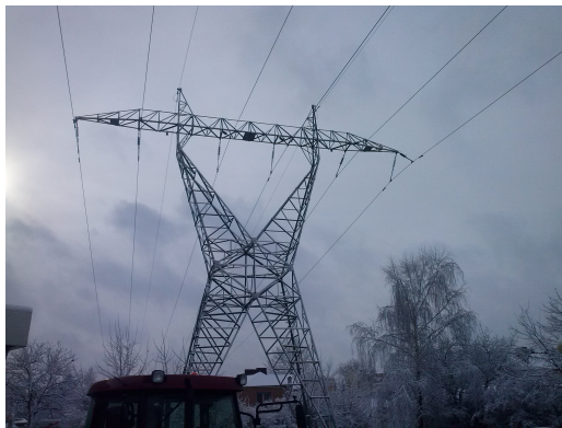
Z2. Słup dawnej linii 150 kV w Starachowicach dziś dla linii 110 kV. (zdjęcie udostępnione przez dr inż. J. Jakubowskiego)
