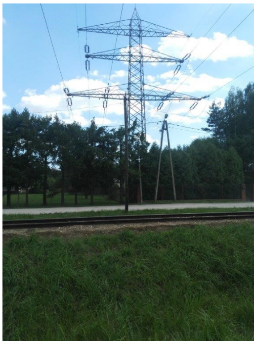
Z3. Słup dawnej linii 150 kV dziś 220 kV we wsi Żłotokłós k/ Warszawy
