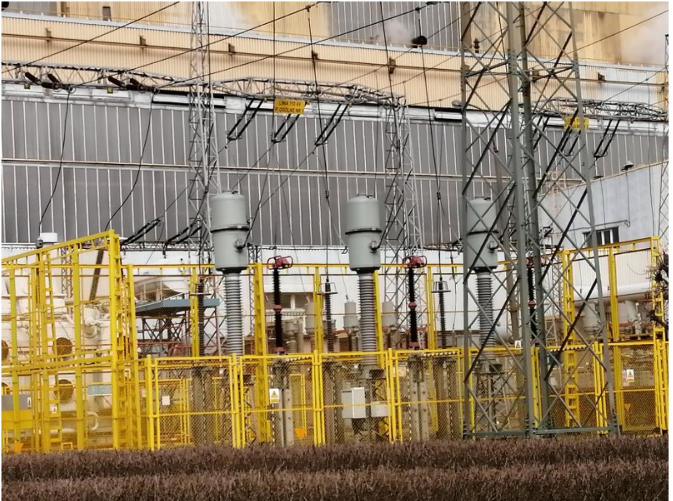
Pole pomiarowe na rozdzielni WN. Widoczny zestaw przekładników kombinowanych (prądowo-napięciowych)
