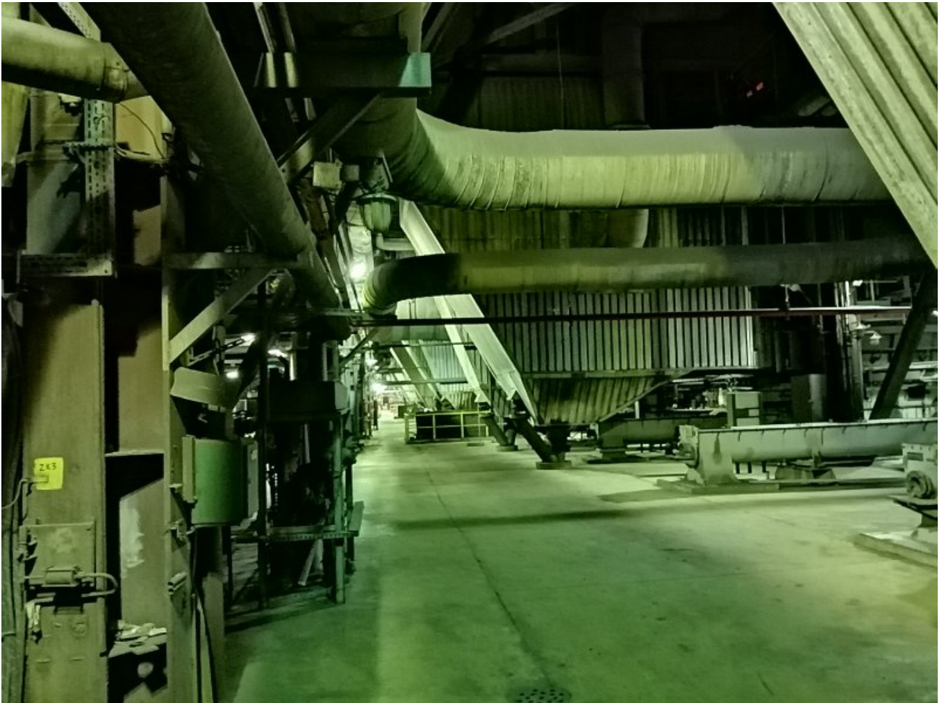
Kotły elektrowni. Kotły węglowe z lat siedemdziesiątych zostały dostarczone od producenta radzieckiego. Dostawcą nowego kotła fluidalnego jest firma Foster Wheeler
