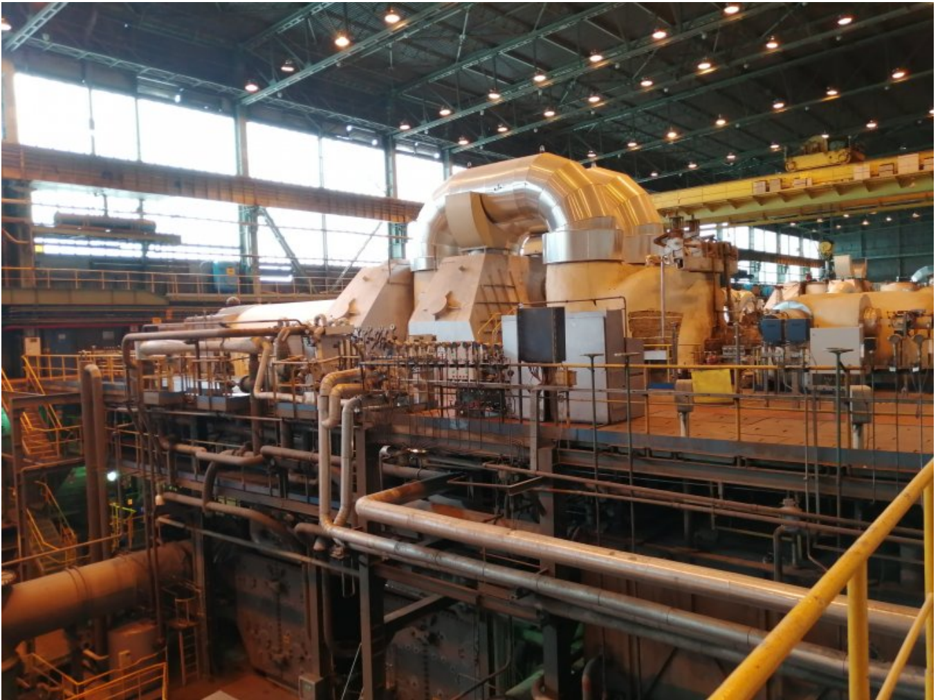
Hala maszynowni Elektrowni Połaniec
