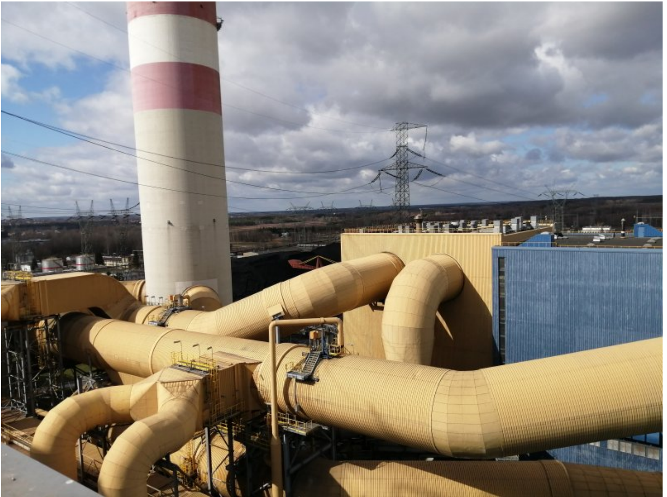
Kolektory gazów spalinowych elektrowni prowadzące do Instalacji Odsiarczania Spalin (IOS)
