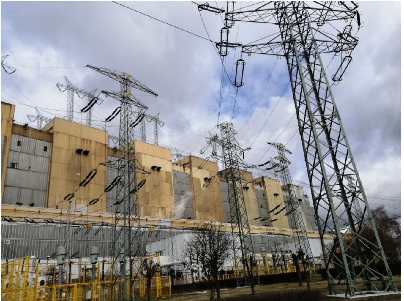
Budynek główny Elektrowni Połaniec z widocznymi słupami końcowymi linii WN
