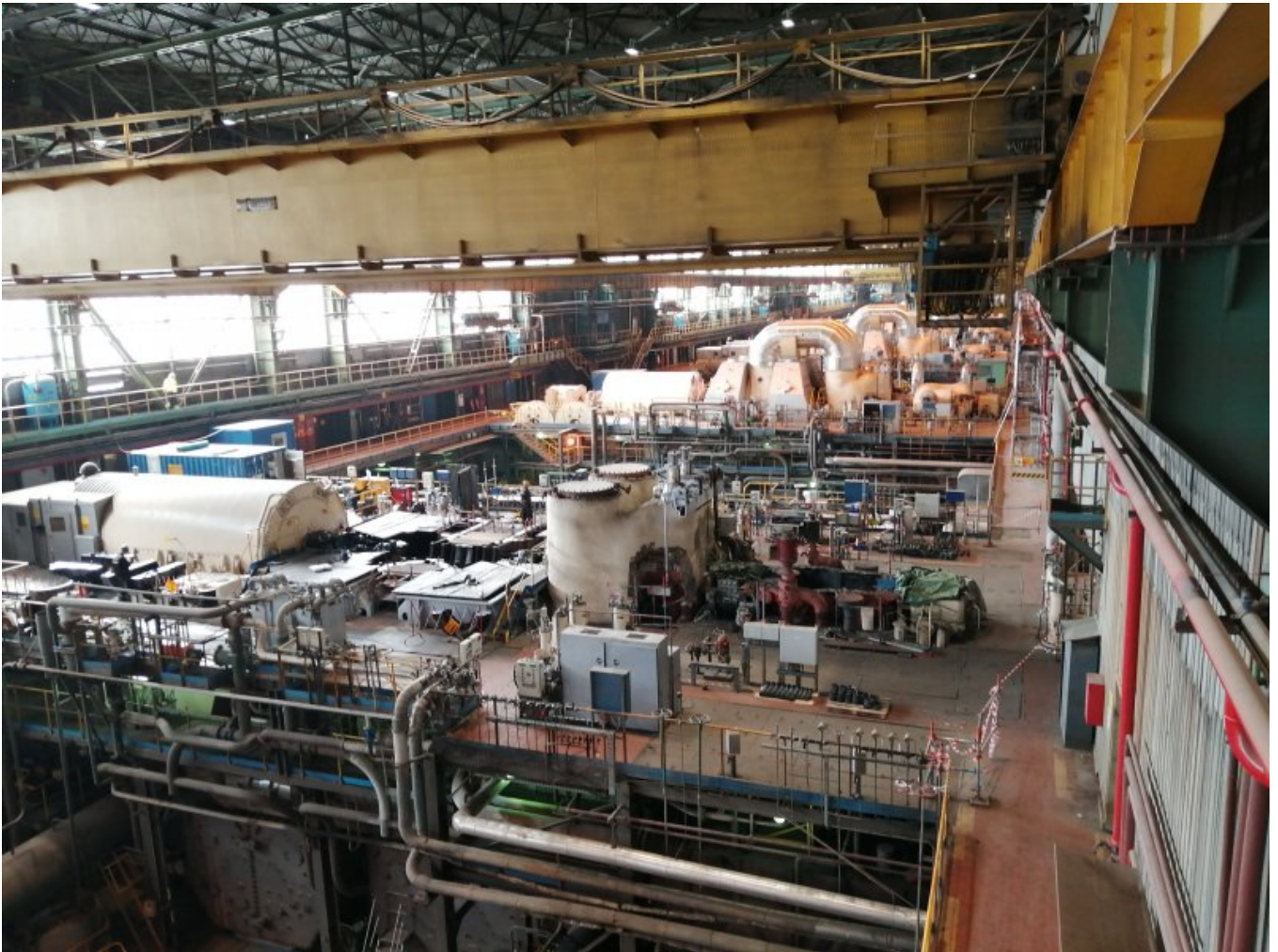
Hala maszynowni Elektrowni Polaniec
