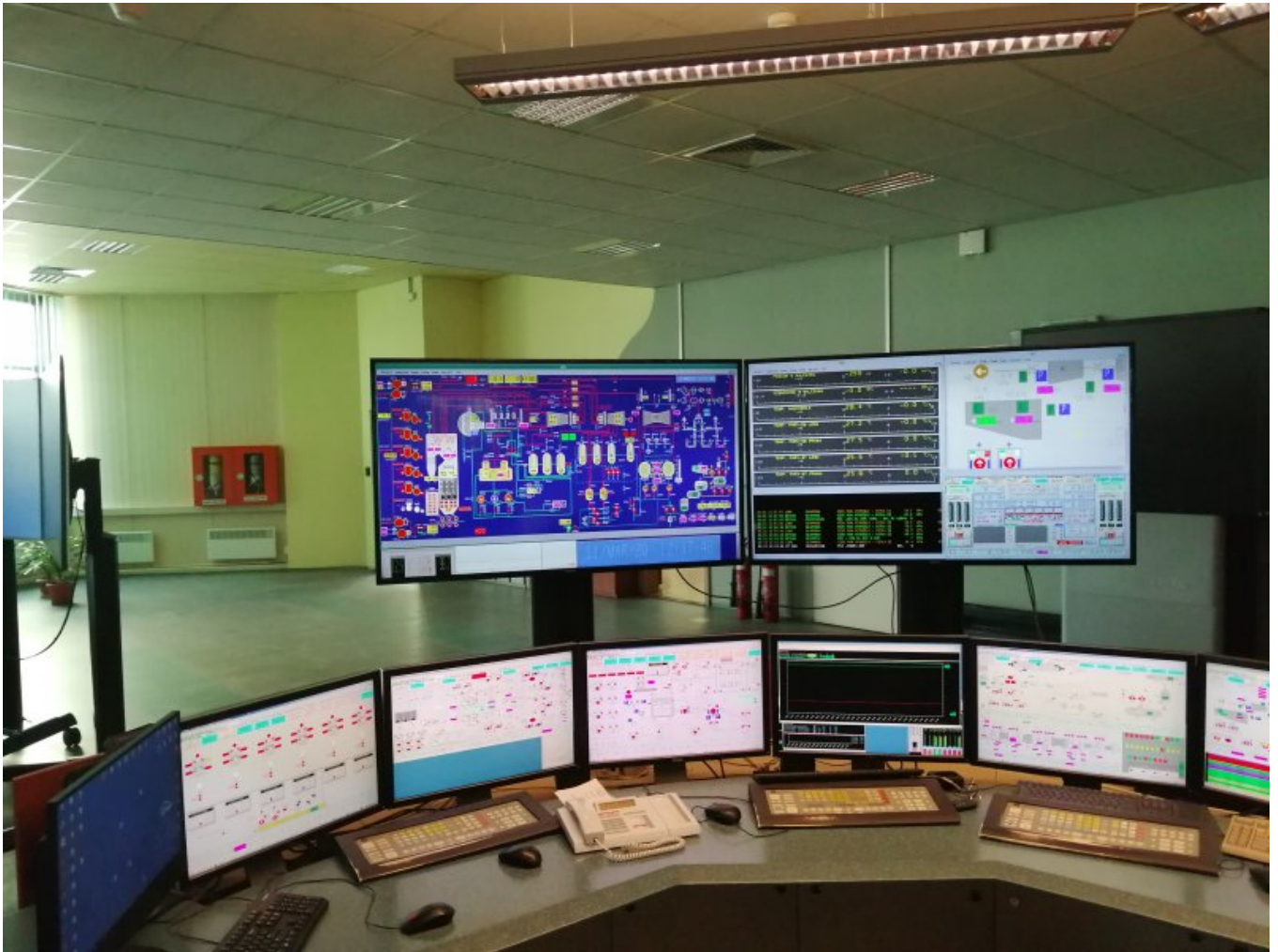
Duże monitory ekranowe prezentują bieżący stan pracy poszczególnych instalacji obiektu
