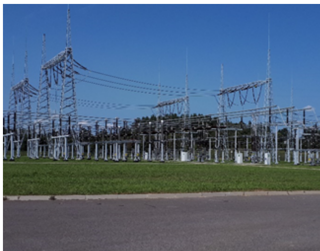
Na zdjęciu: stacja 400/110kV EŁK Bis dla mostu Polska-Litwa
