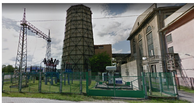
Zdjęcie 10. Ulica Ignacego Mościckiego w Skarżysku-Kamiennej, widok na stację PGE Dystrybucja w obrębie elektrociepłowni – z jednym polem 110 kV wyposażonym m.in. w ograniczniki przepięć (w rozwój których miał udział Ignacy Mościcki) i transformatorem 110/6kV [14]
