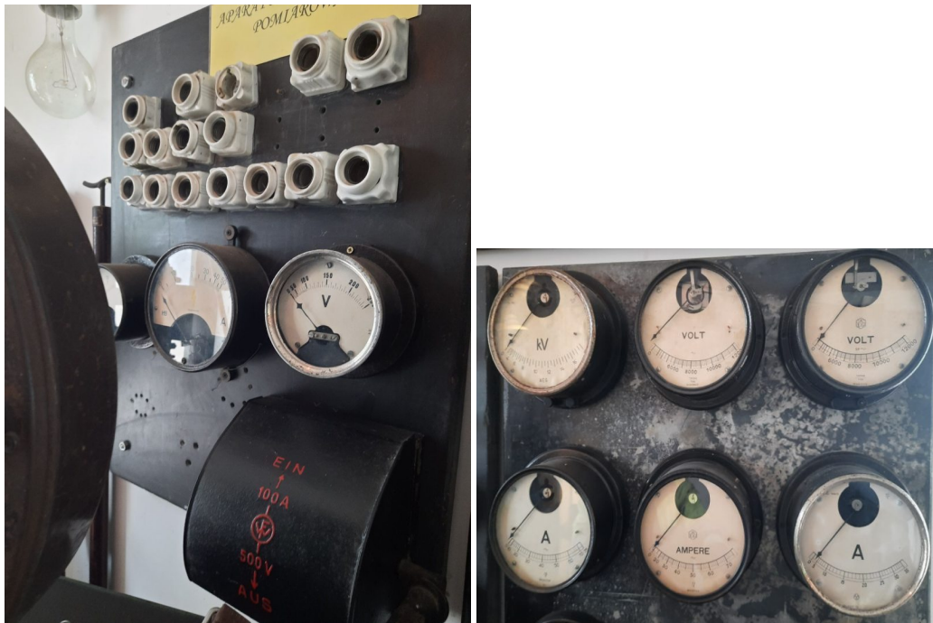
Fot.7 Aparatura pomiarowa i bezpieczniki z elektrowni wodnej Kamienna (autor Andrzej Jutrzenka)
