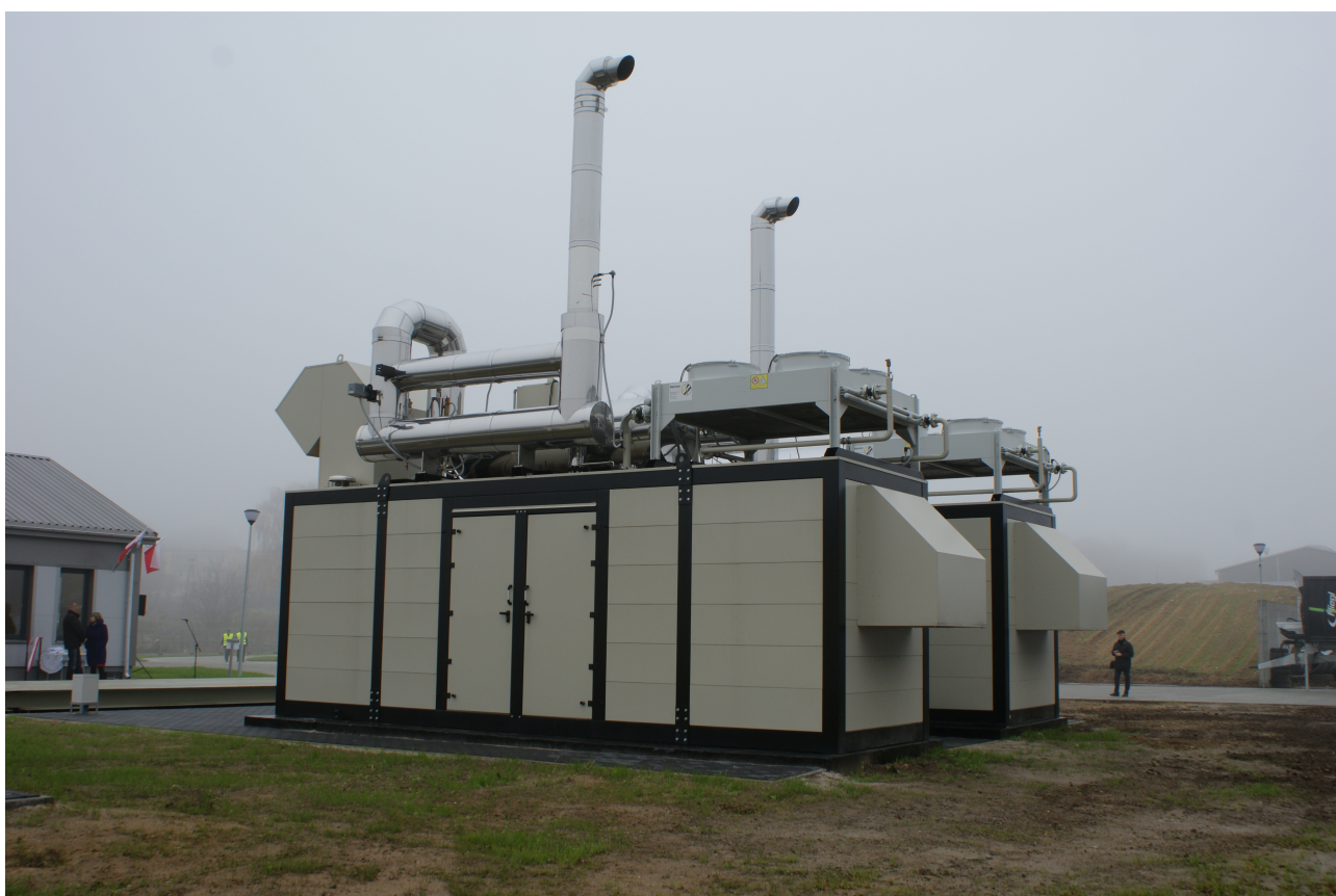
Kogeneratory 2 x 0,5 MWe
