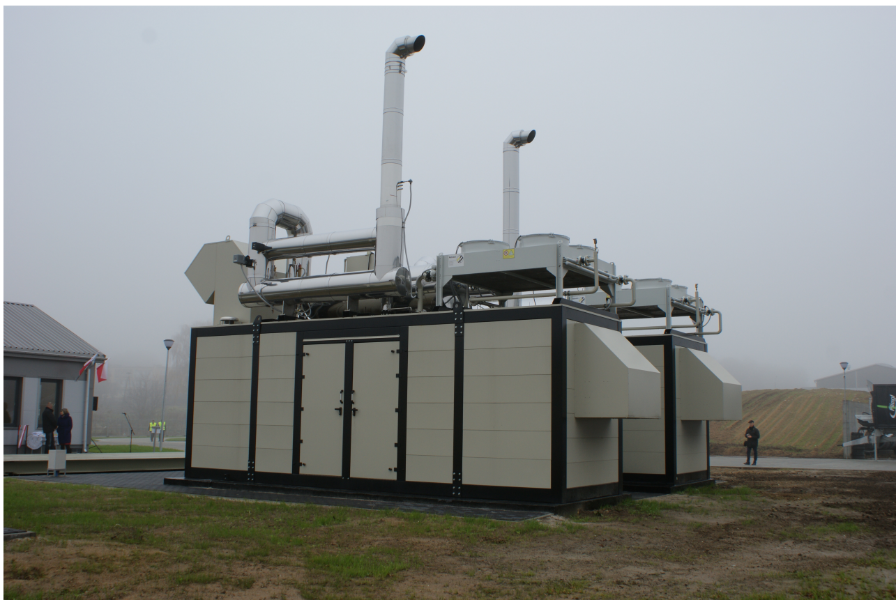
Kogeneratory 2 x 0,5 MWe
