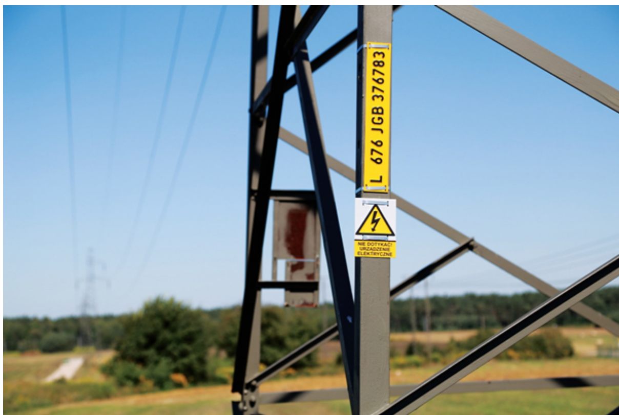
Przykład oznakowania słupa linii 110 kV wykonanego przez Firmę UTAL
