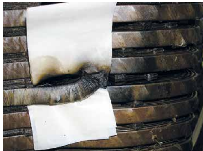
Rys. 4. Uszkodzenie przeplecenia uzwojenia DN fazy L1
