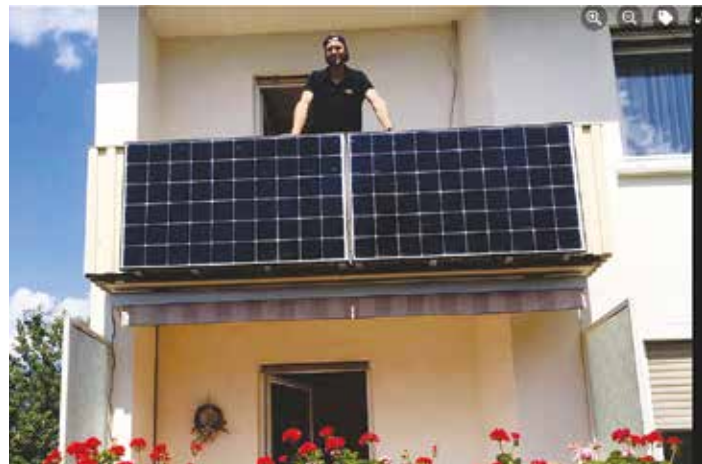
Rys. 5. Mikroinstalacja indywidualnego prosumenta na balkonie budynku mieszkalnego
