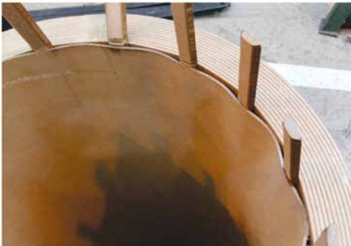
Rys. 10. Widok uzwojenia z odkształconą tuleją wewnętrzną
